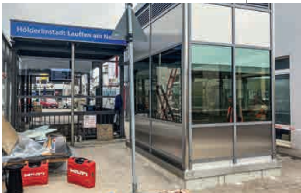
Die neuen Bahnhofs- aufzüge sollen im Sommer in Betrieb gehen.
