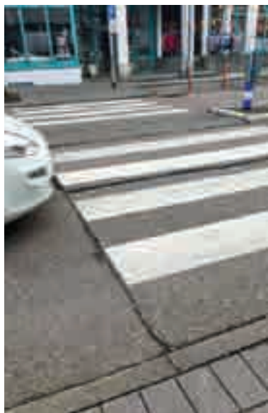
Die Bordsteine an den Zebrastreifen in der Bahnhofstraße sind zu tief, normgerecht wäre eine Querung mit Richtungs-, Aufmerksamkeits- sowie Sperrfeld.
