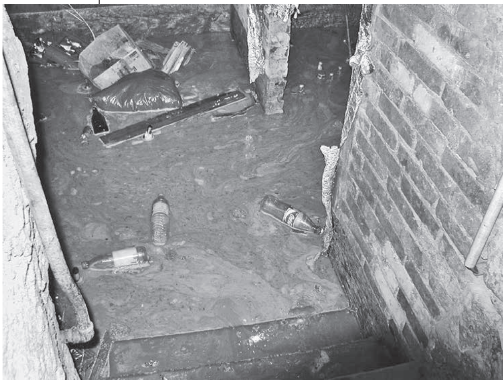
Typisches Schadensbild Kanalarückstau Foto: Feuerwehr
