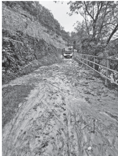
Starkregen am 17.06.2020 am Neckartalradweg mit starken Schlammablagerungen
