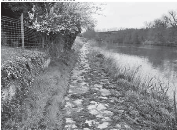
Enastelle, schadhafter Plattenbelag
