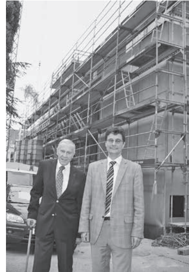
Stiftungsvorstand Dr. Eckhart Lohbeck (links) und BW-Vorstand Hans-Christoph Ketelhut freuen sich darüber, wie schnell der Bau des Wohnprojekts voranschreitet.
