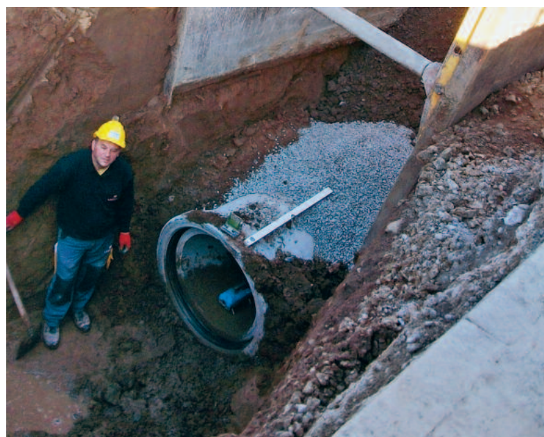
Durch tief liegende Kanäle gestaltete sich die Kanalaufdimensionierung in der Seestraße schwierig.
